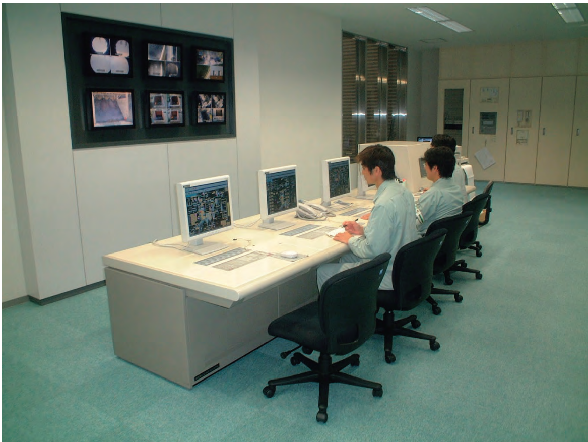
写真 10-5-31 中間処理施設 中央制御室
