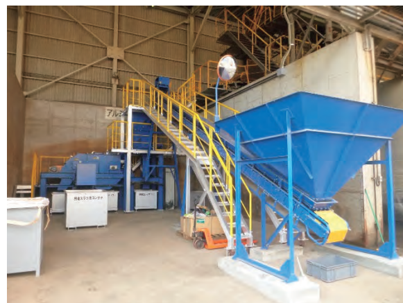
写真3-2-4-1 アルミ選別設備
