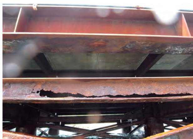
写真3-1-4-2-4 破口したH鋼材（豊島専用棧橋）
