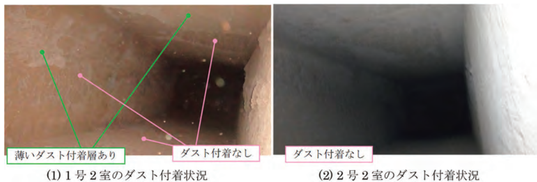
写真7-4-2-2-3 ボイラー2室のダスト付着状況写真 (写真撮影方向②)
