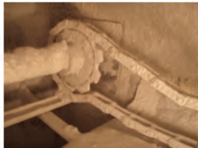
エレベーションガイドが外れた箇所
