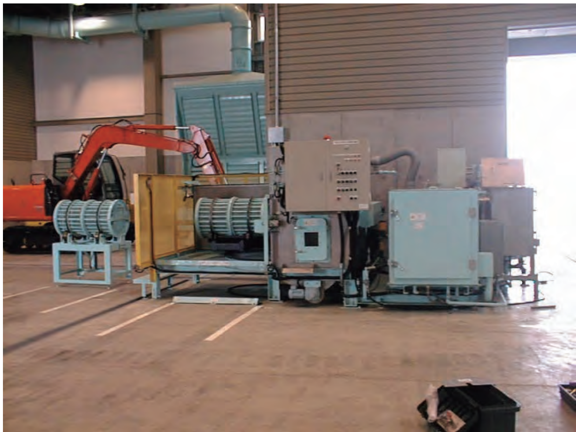
写真 10-5-19 特殊前処理物処理施設 洗浄機
