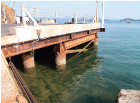
写真 3-1-4-2-5 鋼材の状況（直島専用棧橋）
