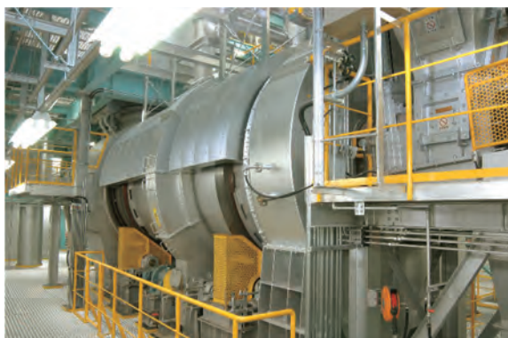
写真 3-1-5-3-2 ロータリーキルン炉
