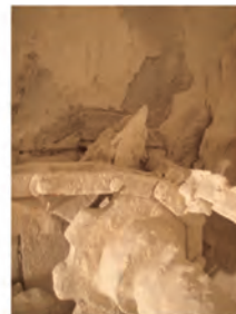
外れたエレベーションガイドが噛み込んでいた箇所
