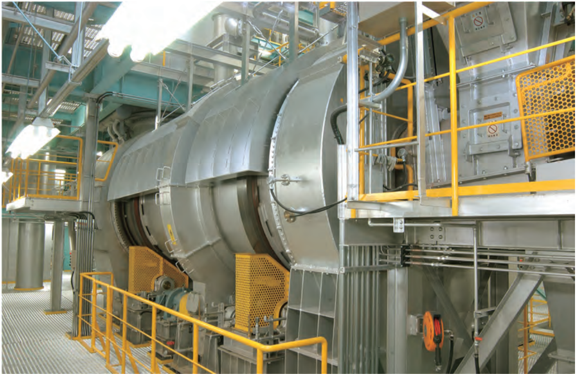
写真 10-5-30 中間処理施設 ロータリーキルン炉
